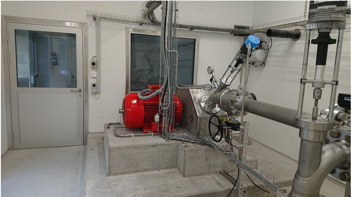
Bildlegende: Blick in die Druckreduzierstation in Göschenen mit Pelton turbine und Generator.
