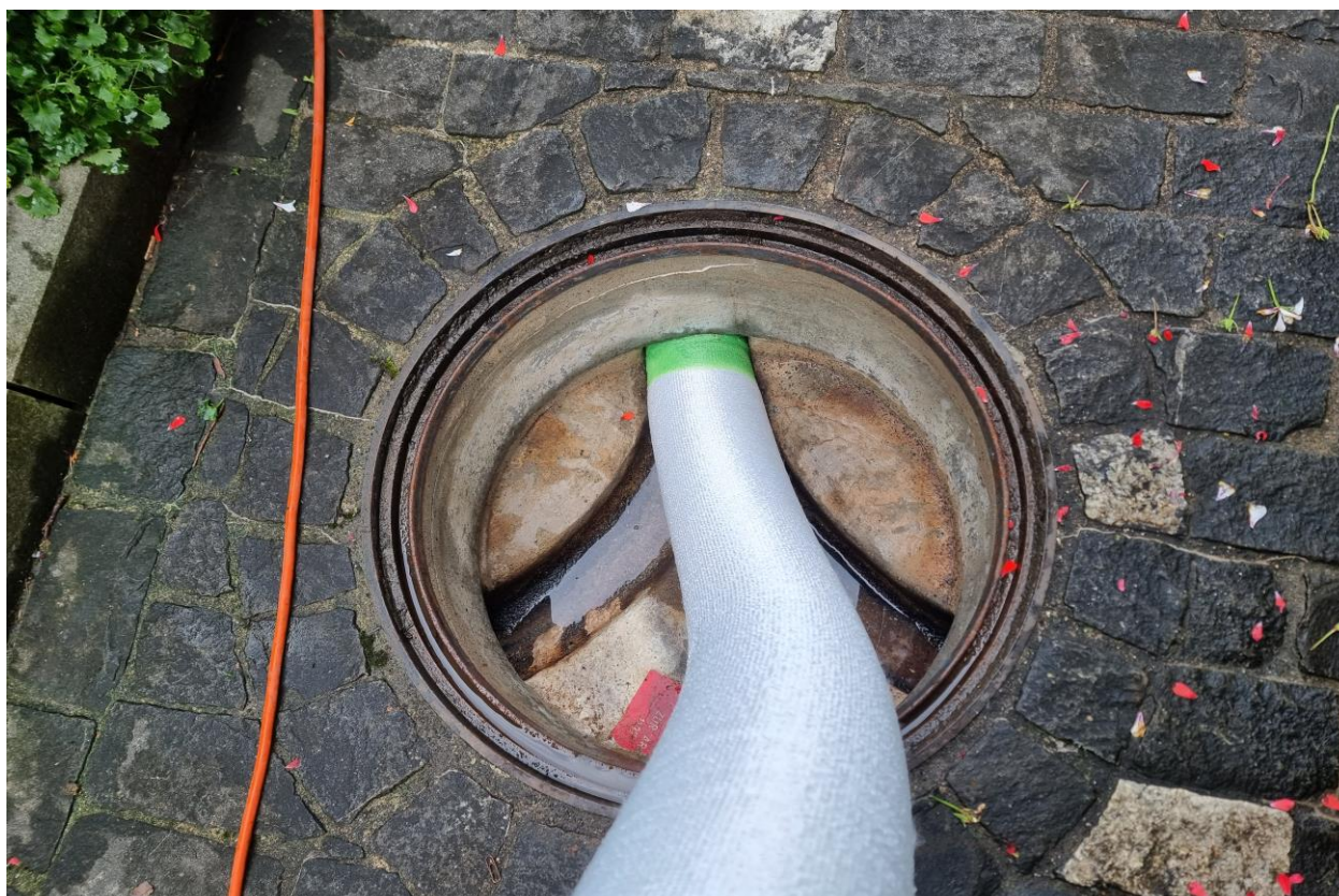
Bild Abwasser Uri: Das Inlinerverfahren stellt eine effiziente und kostengünstige Sanierungsvariante von Abwasserleitungen dar. Die so sanierten Leitungen garantieren wieder den einwandfreien Betrieb während Jahrzehnten. Die Abbildung zeigt einen Linereinzug bei einer Schmutzwassersammelleitung mit einem Durchmesser von 15 Zentimetern.
