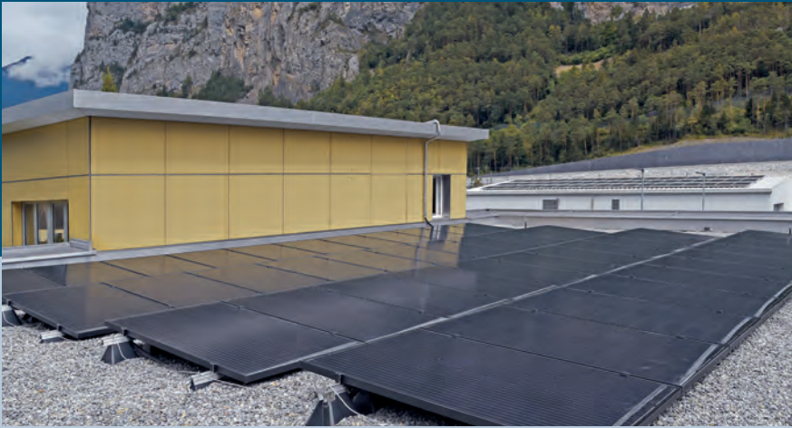
Die Solaranlage auf dem Dach ist bereits in Betrieb, demnächst folgen die Fassadenmodule.
