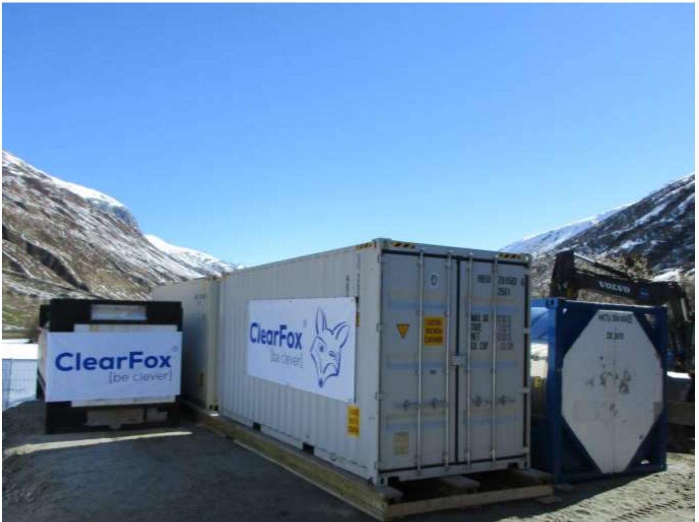
Bild Abwasser Uri: Mobile Kleinkläranlage im Einsatz in Realp während dem Umbau der ARA Realp in ein Abwasserpumpwerk
